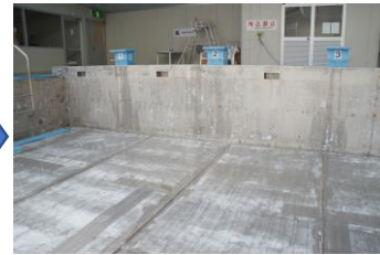
塗装剥離 H31.1.25
